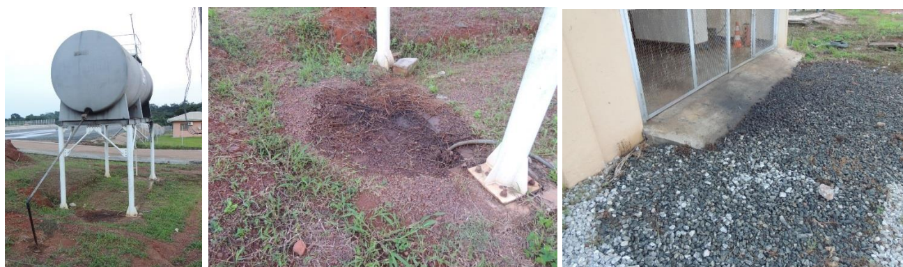
Figure 2-4: Centrale thermique, cite MOE
