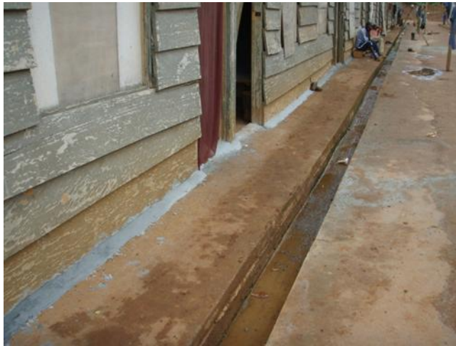
Figure 4-4: Protection contre l'inondation des chambres inopérante
