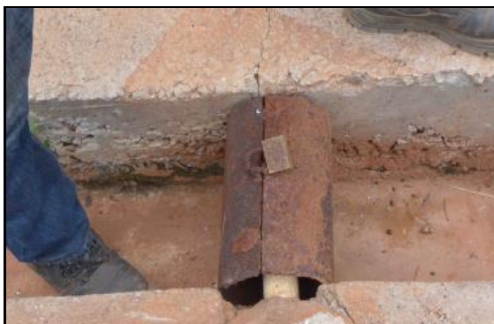
VANNE DE DRAINAGE DU STOCKAGE CARBURANT PRINCIPALE EN POSITION OUVERTE DANS SA PROTECTION ROUILLEE. A CHANGER
