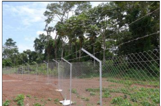
...QUI, SEMBLE-T-IL A ETE INSTALLEE A L'ENVERS (LE RETOUR ANTI-PENETRATION DEVRAIT ETRE DIRIGE VERS L'EXTERIEUR)
