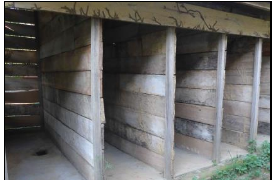
...TOUT COMME LES TOILETTES (SANS FERMETURE)
