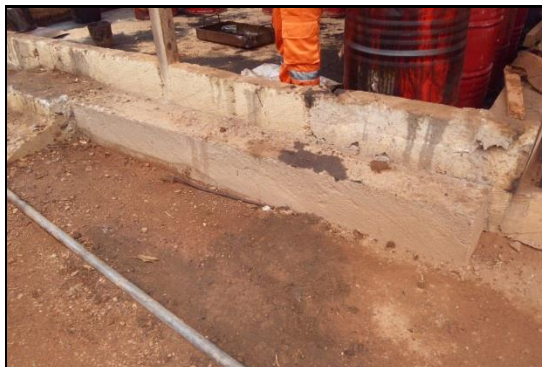
GARAGE PRINCIPAL: SOL CONTAMINE PAR LES HUILES DEVANT LE STOCKAGE.
