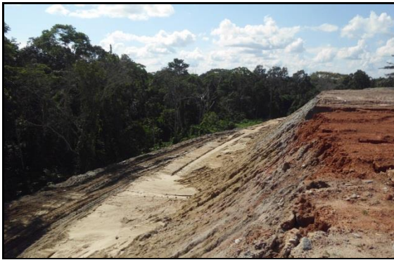
DEPOT CARRIERE: REPROFILAGE ET BERMES EN COURS DE REALISATION MAIS NOTER L'ABSENCE DE DRAINAGE
