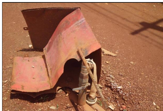
BVO: UN POINT DE CONNEXION ANTI-INCENDIE ENDOMMAGÉ PAR UN VÉHICULE DOIT ÊTRE RÉPARÉ RAPIDEMENT
