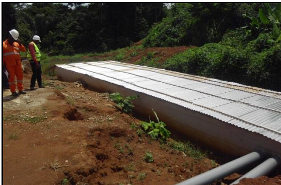
BVO: LA FOSSE SEPTIQUE DU NOUVEAU BLOC TOILETTE EST FONCTIONNELLE
