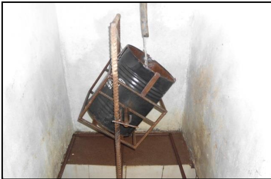
BVO: SYSTEME DE CHASSE AUTOMATIQUE DES TOILETTES FONCTIONNEL. CI-DESSUS REMPLISSAGE ....
