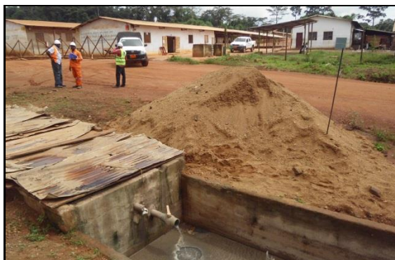
BVO: LA FOSSE SEPTIQUE DES CUISINES RESTE PEU EFFICACE MAIS DOIT ÊTRE REHAUSSEE POUR ACCROÎTRE SA CAPACITÉ
