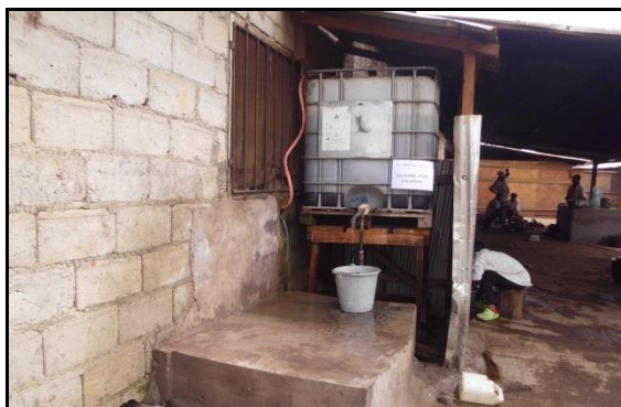
BVO: POINT D'EAU CUISINE 1, MAINTENANT SEPARÉ EN ZONE DE LAVAGE (CI-DESSUS) ET...
