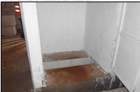
BVO: VUE D'UNE NOUVELLE TOILETTE AVEC PORTE ET CANAL D'ECOULEMENT CARRELE
