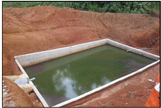
LE BASSIN ANAEROBIE EST OPERATIONNEL DE MEME QUE...
