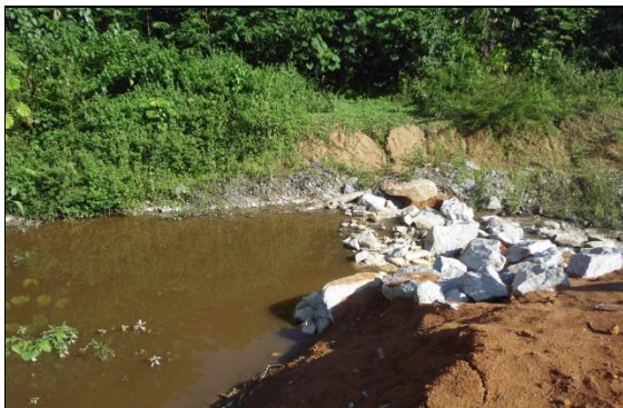
EN RAISON DE LA CONCEPTION INAPPROPRIEE DU DEVERSOIR (TROP BAS ET NON ETANCHE SUR SA HAUTEUR)
