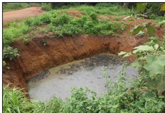
LE BASSIN ANAÉROBIE À L'AVANT DE LA FOSSE, NON REVÊTU, EST EN FAIT UN BASSIN D'INFILTRATION DE L'EFFLUENT....
