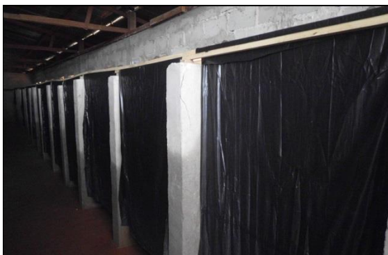
BVO: NOUVEAU BLOC DOUCHE AVEC RIDEAUX PLASTIQUES
