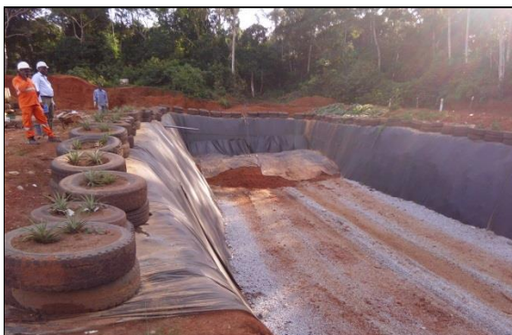
LA NOUVELLE CELLULE DECHETS EST FONCTIONNELLE MAIS IL SEMBLE QUE PEU DE DECHETS Y ONT ETE DEPOSES....
