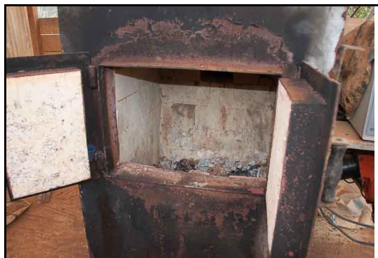
ET ETAT DE DEGRADATION EQUIVALENT POUR LE FOYER REFRACTAIRE
