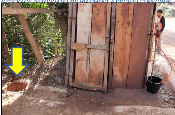
MAGASIN EXPLOSIF: PETIT STOCKAGE GASOIL AVEC Puits DE RECUPERATION EN CAS DE DEVERSEMENT (FLECHE) INSUFFISANT POUR UN RECIPIENT DE 200 LITRES
