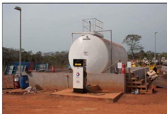
AIRE DE RETENTION DU STOCKAGE CARBURANT
