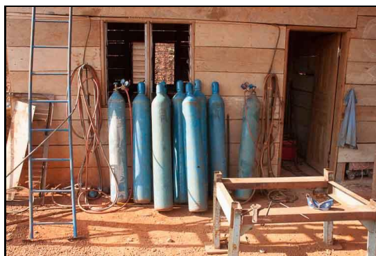
BOUTEILLES D'OXYGENE SANS FIXATION, POUVANT BASCULER ET BLESSER GRIEUREMENT EN DE NOMBREUX ENDROITS DES CHANTIERS
