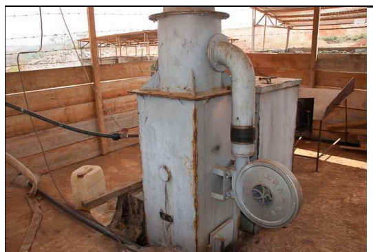
VUE DE L'INCINERATEUR "NEUF" INSTALLE PAR CWE POUR LES DECHETS MEDICAUX
