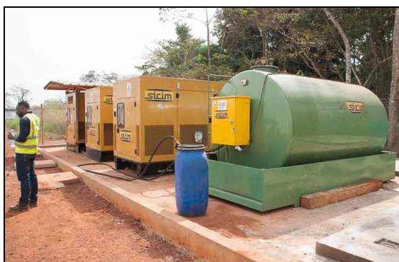
AIRE DE RETENTION DES GENERATEURS. NOTER LA RETENTION ADDITIONNELLE POUR LE STOCKAGE GASOIL
