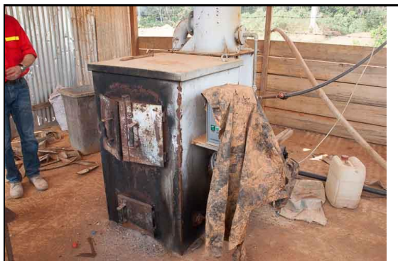
ASPECT TRES DEGRADE DE L'EXTERIEUR DE L'EQUIPEMENT APRES QUELQUES ESSAIS SEULEMENT...
