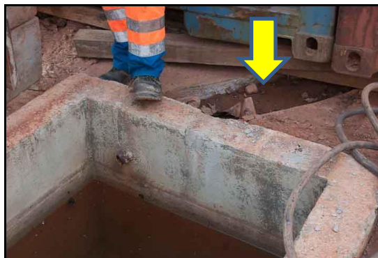
L'ENTRÉE DANS LE DESHUILEUR EST TOTALEMENT COLMATÉE PAR DES SEDIMENTS (FLECHE)
