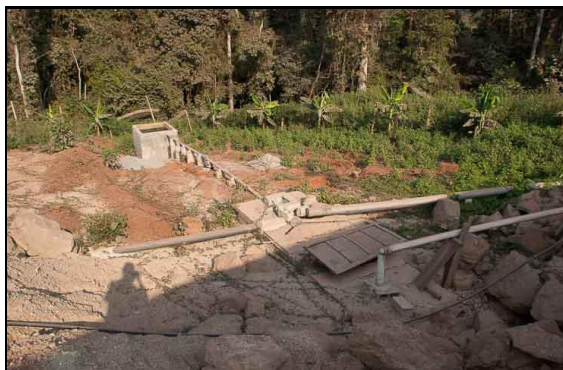
STATION DE TRAITEMENT DE LA BASE VIE CONCASSEUR
