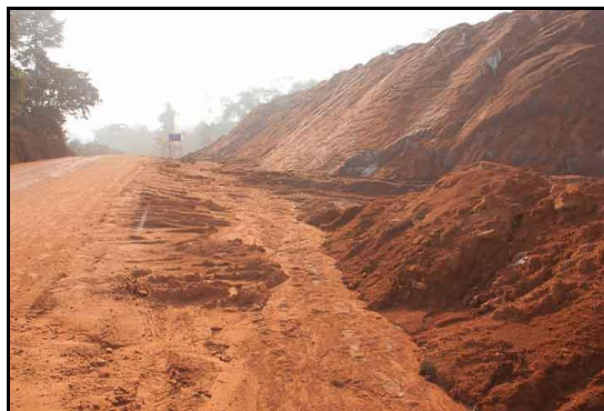
ZONES DE DEPOTS NON CONFORMES ET SANS DRAINAGE
